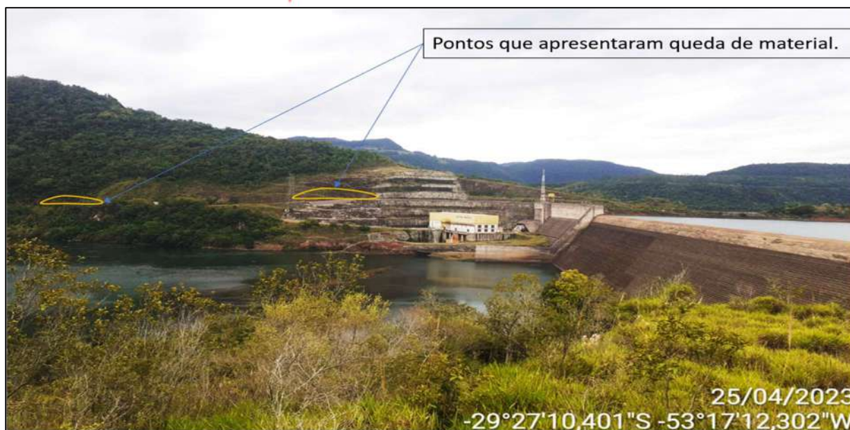
Figura 19 – Pequenos desprendimentos de material rochoso (pequena magnitude) na ombreira direita (abril/2023).
